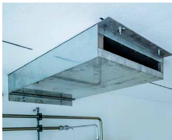
Izolowany akustycznie kanał z blachy.
