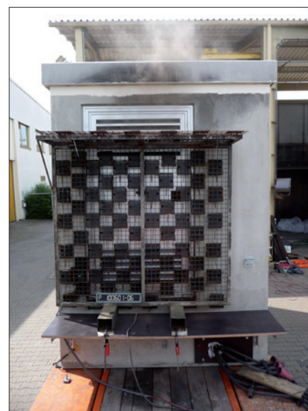
Obr. 7. Blokovaná transformovna po zkoušce obloukovým zkratem, která ověřila její bezpečnost pro veřejnost. Všechny dveře, víka a poklopy zůstaly zavřené. V popředí je rám s textilními indikátory tepelných a tlakových účinků elektrického oblouku
