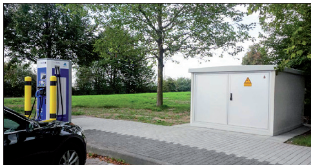
Obr. 2. Transformační stanice na veřejném prostranství pro napájení nabíjecího sloupku
