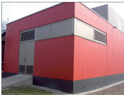
Obr. 2. Příklad integrace transformátorové stanice do zástavby
