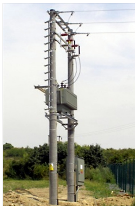
Obr. 2. Sloupová transformační stanice
