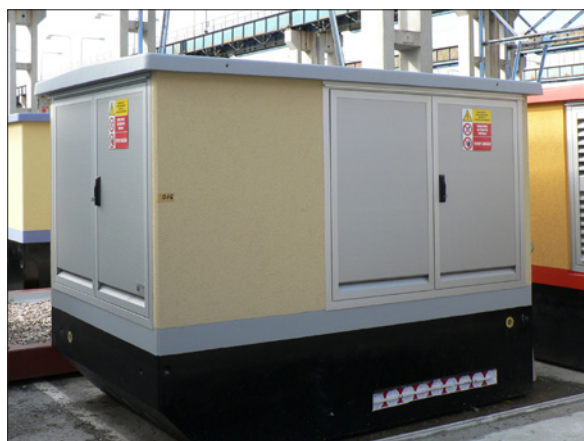
Obr. 3. Kompaktní transformační stanice (kiosková)
