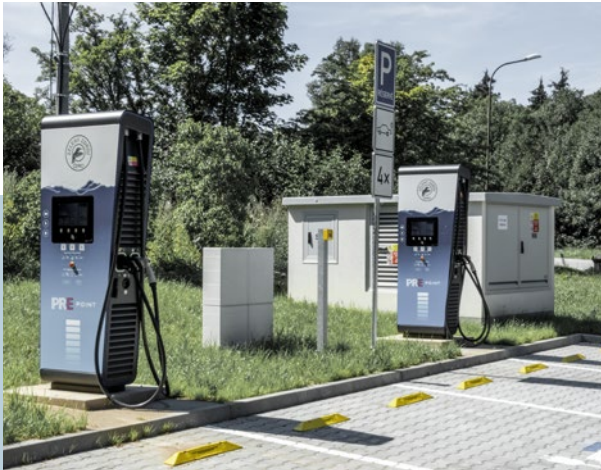
ČERPACÍ STANICE ŽACLÉŘ
