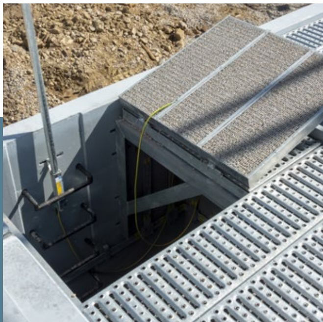
Revizní vstup s nástupní tyčí
