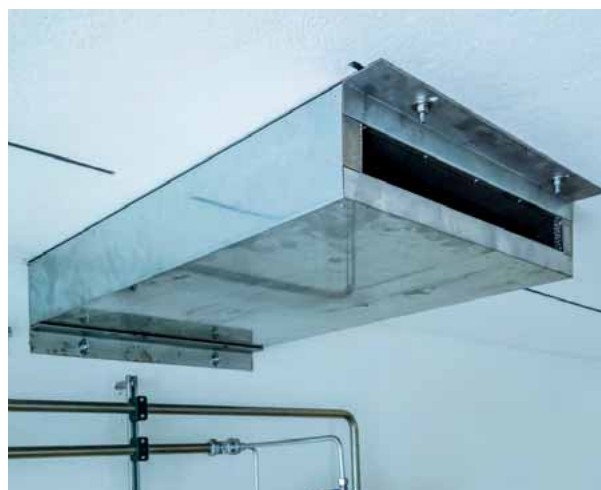
Zvukově izolovaný plechový kanál.
