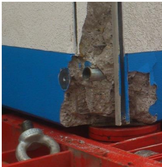
Obr. 8: Deformace způsobená nedovoleným způsobem zdvihání
